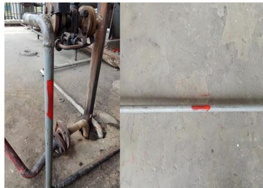
尾气到燃烧炉管道及流向标识
