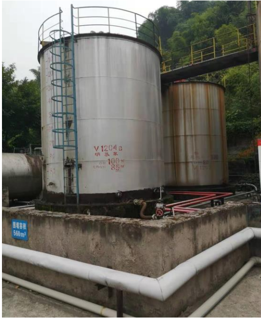
硝基苯储罐及围堰设置情况图
