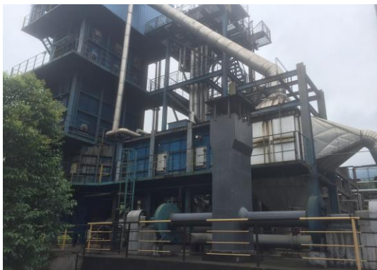
废气处理设施：转化炉
