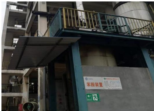
危险废物打包点防雨措施
