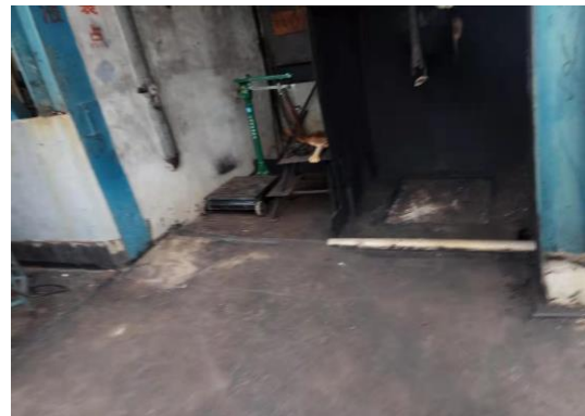
危险废物打包点防渗防腐措施
