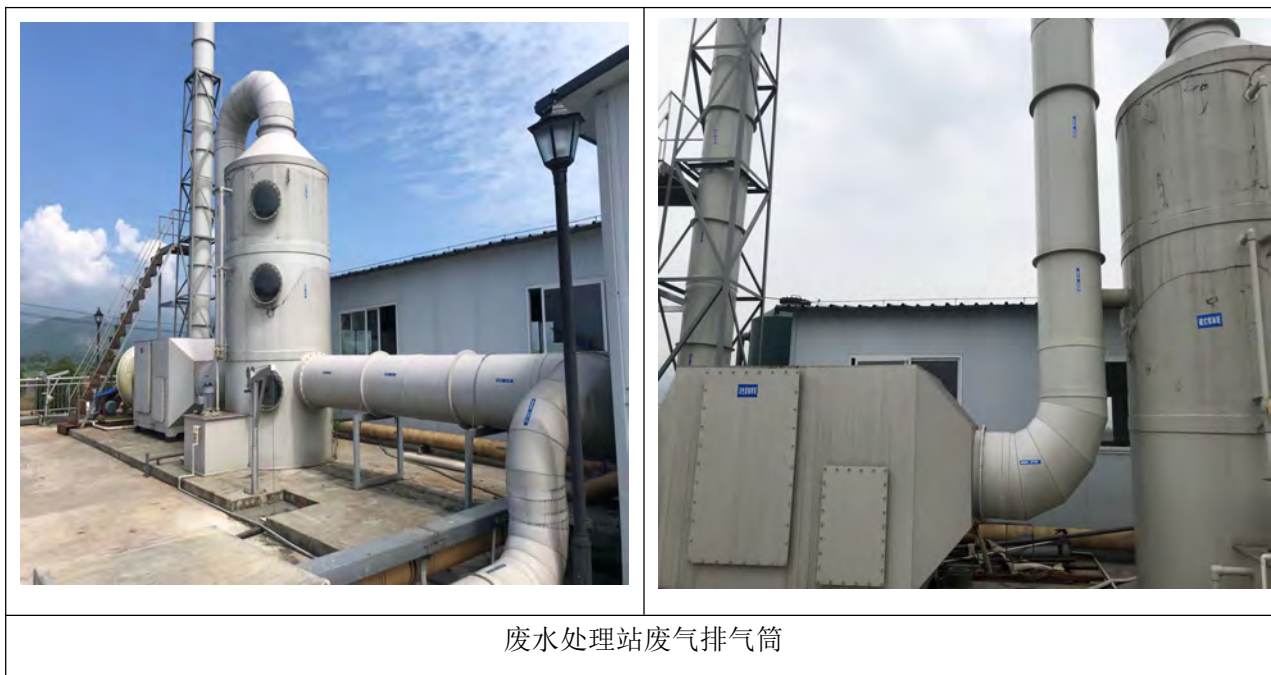
图 4-7 废水处理站废气处理设施设置情况图
