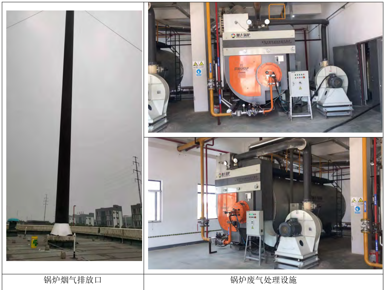
图 4-5 锅炉废气处理设施设置情况图
