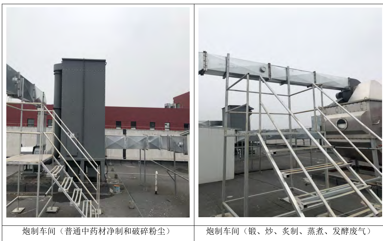
图 4-3 炮制车间废气处理设施设置情况图
