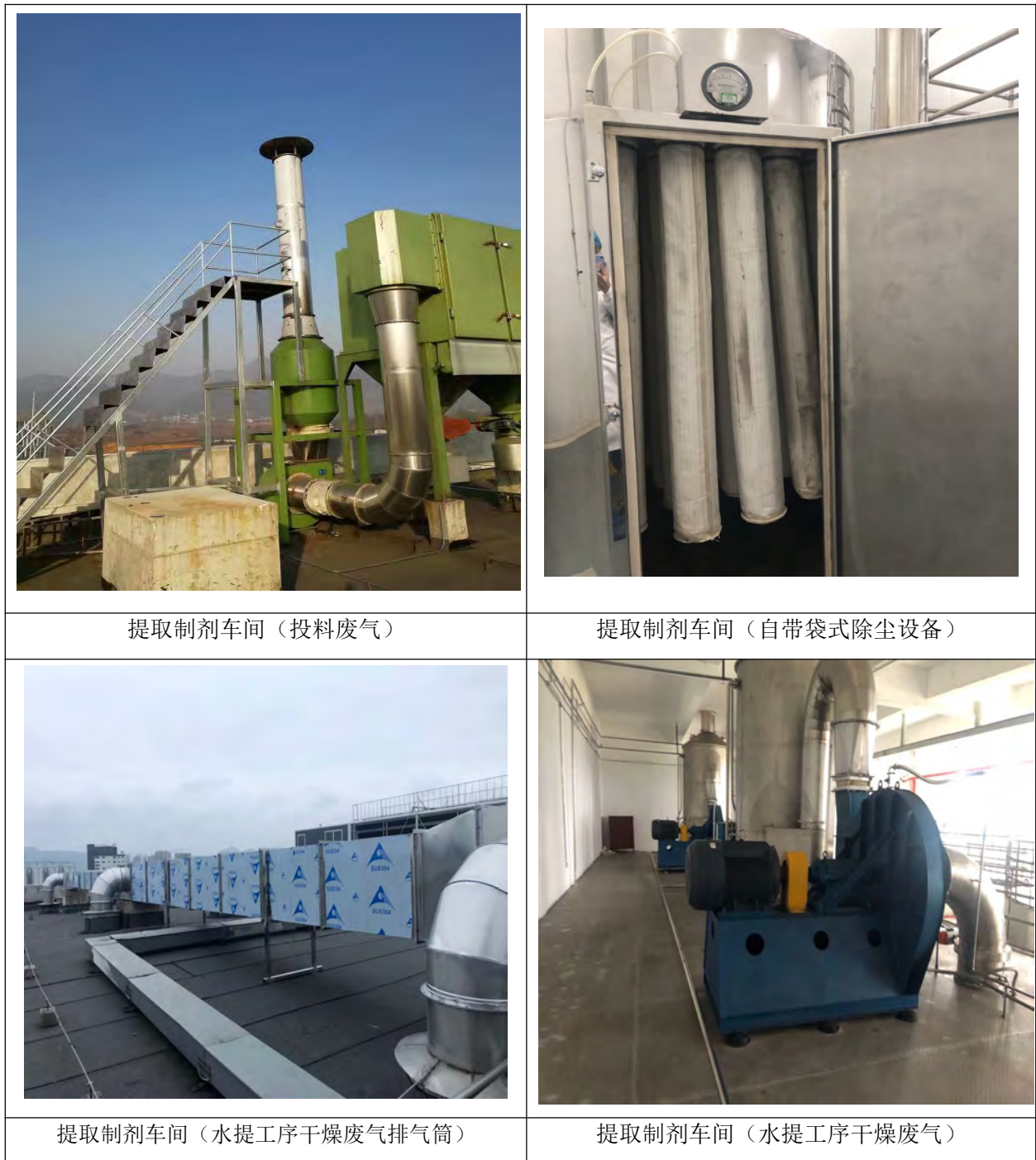
图 4-4 提取制剂车间废气处理设施设置情况图
